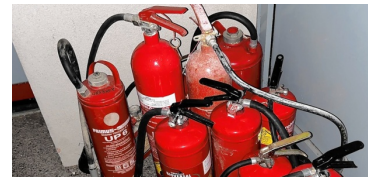
▲ Feuerlöscher müssen regelmäßig überprüft werden. Foto: privat
