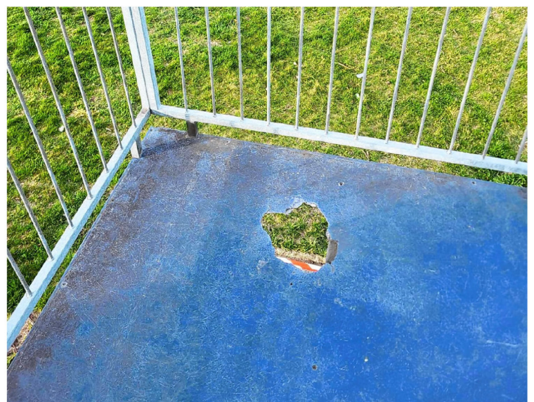
▲ Der Belag am Funcourt wurde schwer beschädigt und regelrecht durchlöchert hinterlassen.
