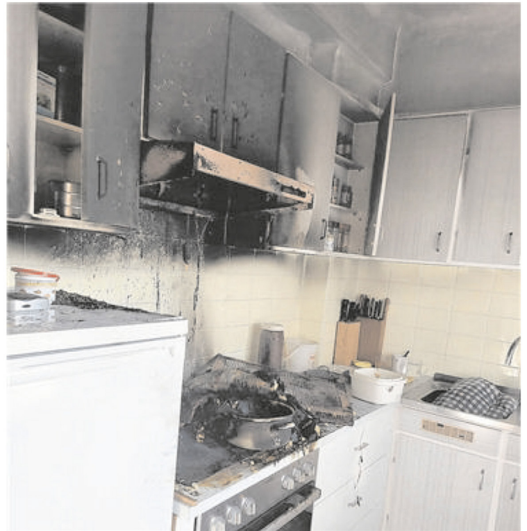
▲ Sonntagvormittag fing eine Pfanne mit Öl Feuer. Die Bewohner konnten den Brand durch Abdecken selbst löschen. Foto: FF Mannersdorf
