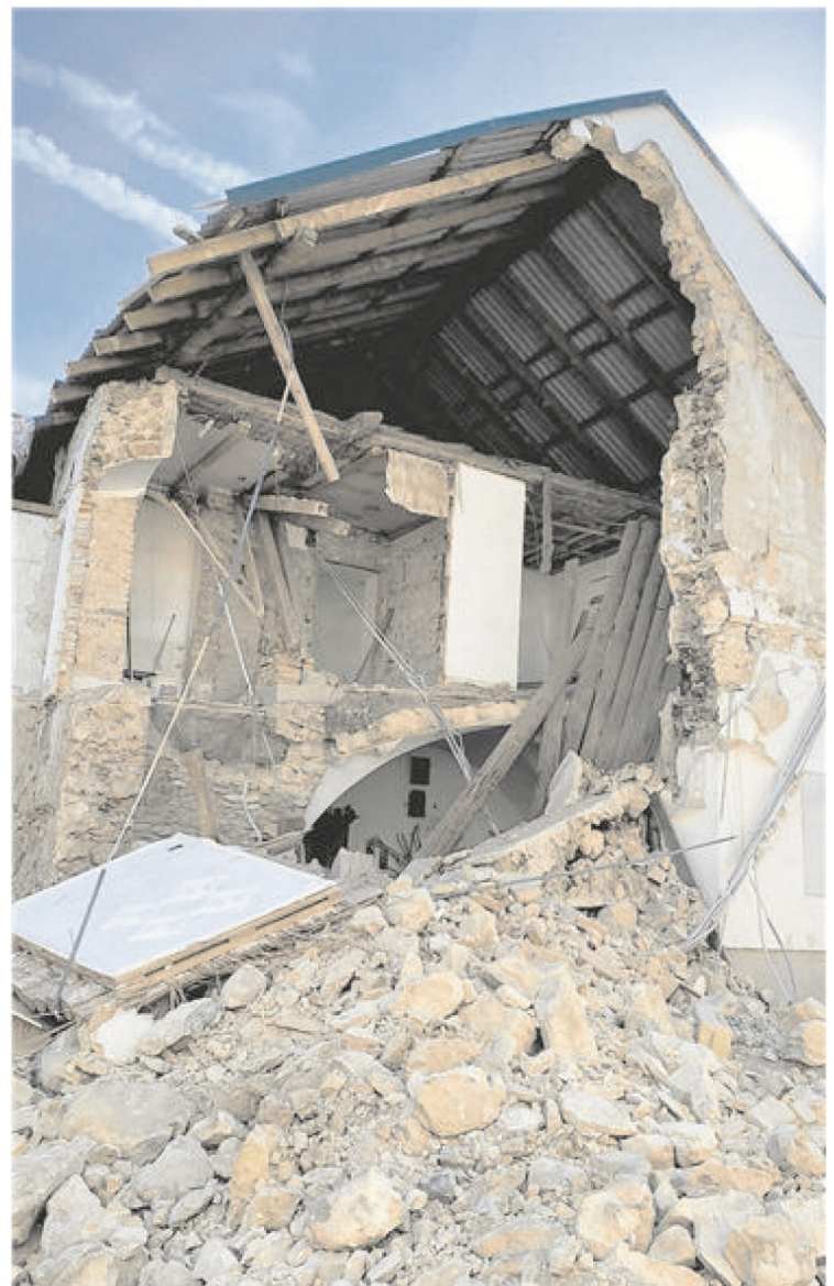
▲ Das eingestürzte Gebäude sorgte in Mannersdorf für jede Menge Aufsehen. Fotos: Feuerwehr Mannersdorf
